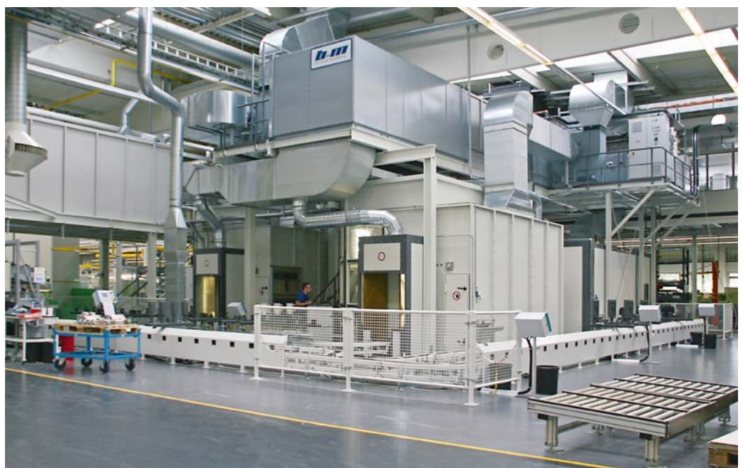
Blick auf die installierte Gesamtanlage mit den zwei Aufgabestationen.
