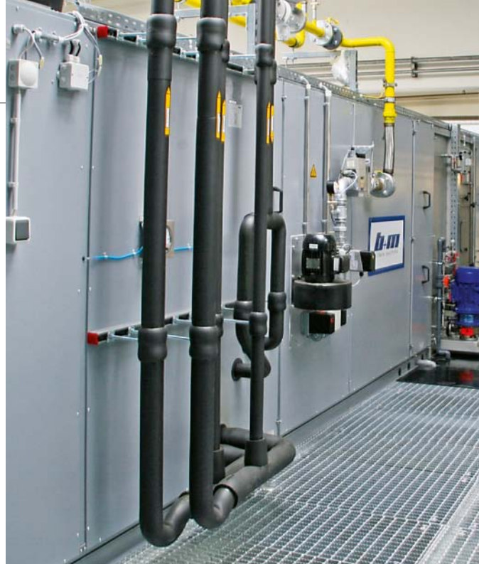
Die vollklimatisierte Zuluftanlage wird über die integrierte „b+mAir“-Energiesparsoftware gesteuert.
